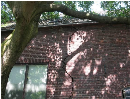
Foto 7: scheur in de muur van het gebouw
