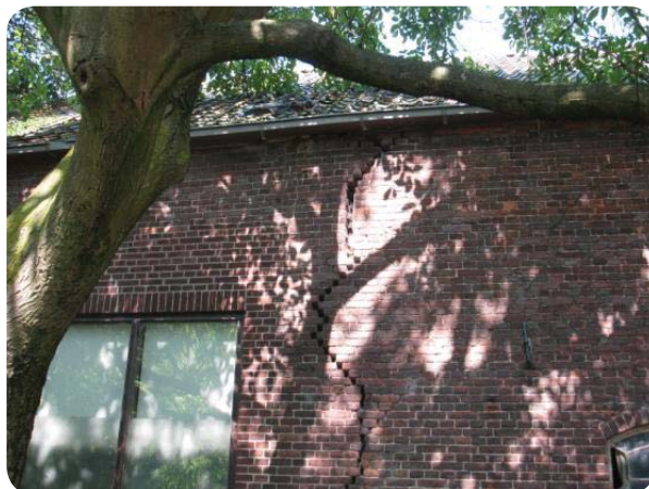
▲ scheur in muur van het gebouw
