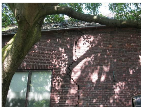
Foto 7: scheur in de muur van het gebouw
