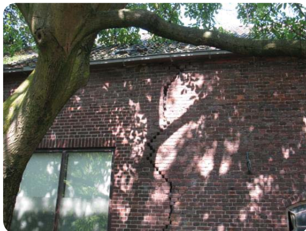
▲ scheur in muur van het gebouw
