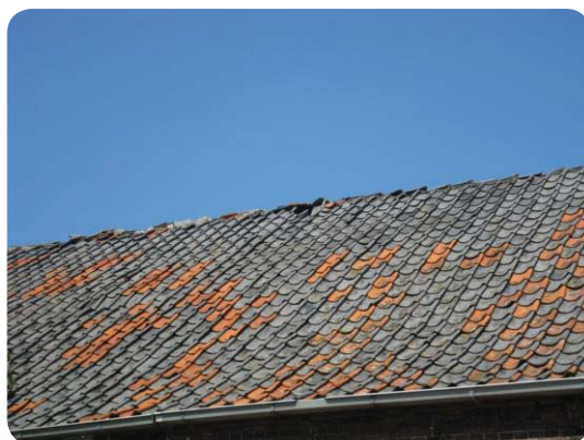
▲ losliggende dakpannen als mogelijke verblijfsplaats voor zwaluw en mus
