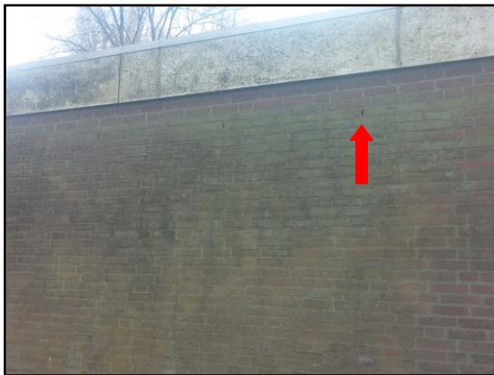
Foto 7: Spouwgaten in gymnastieklokaal
