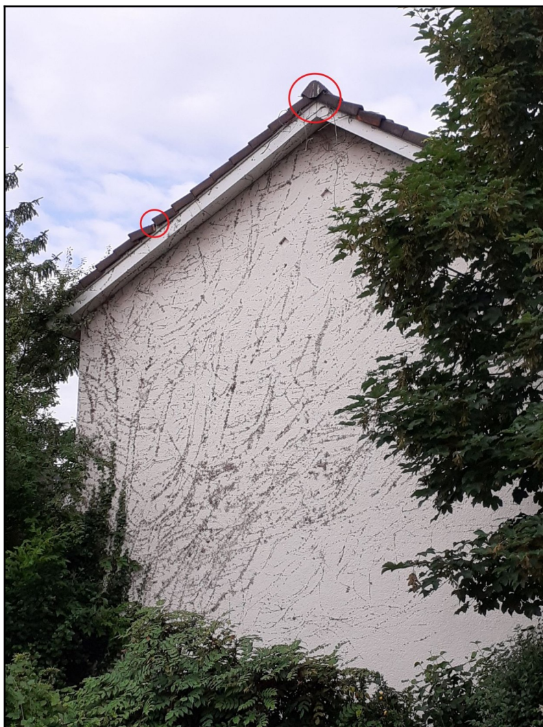
Afbeelding 9: Kopse gevel aan de Anna Paulownastraat waar door gebrek aan onderhoud openingen zijn ontstaan (rood omcirkeld). Foto: L.D. van Drongelen | Ecoresult B.V.
