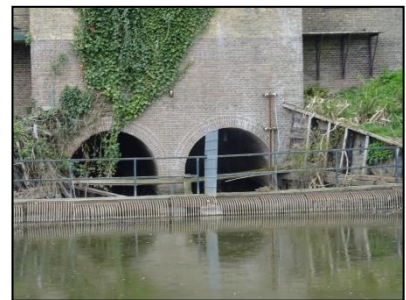
Figuur 5. Gemaal aan de zuidzijde van de onderzoekslocatie.
