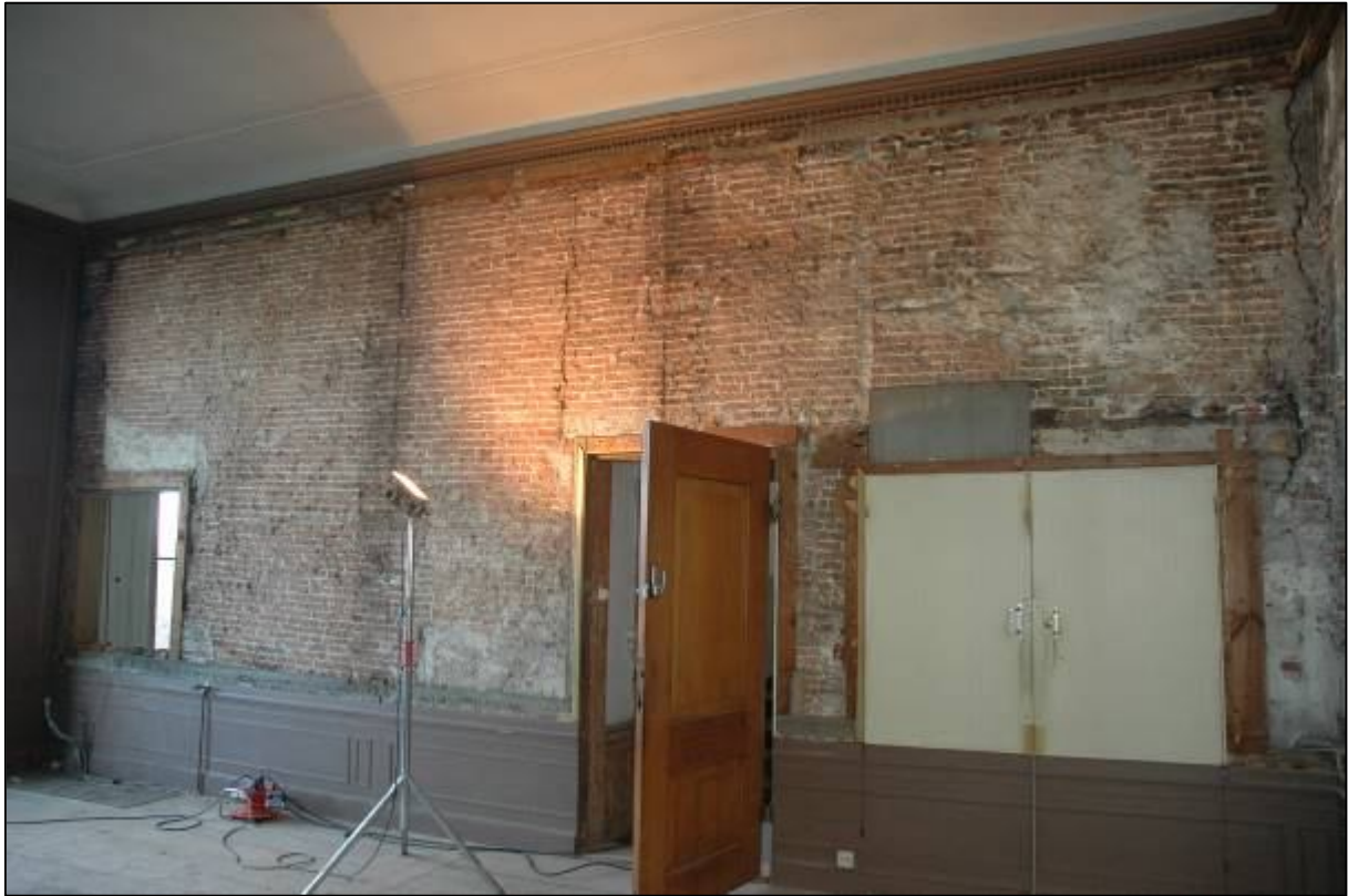
Afb. 18: Ruimte 0.07, de rechterwand. Men heeft er herhaaldelijk aanpassingen aan deuren en lambrisering gedaan. Doordat de wandbespanning – met uitzondering van reepjes bovenaan – met de bijbehorende tengels is weggehaald, is het metselwerk zichtbaar. Vergelijking wijst uit dat dit 18de-eeuws werk is. Op een enkele plek (zie 0.03) wordt een stuk muur aangetroffen dat afwijkt en ouder kan zijn. Nabij de achtergevel is een oude toegang die direct tot de het portaal bij de achterdeur leidt, nog half weggewerkt.
