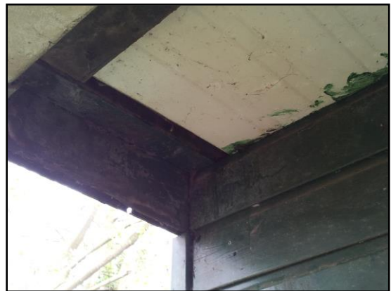
Foto 8: Opening in daklijst aan zuidzijde woning
