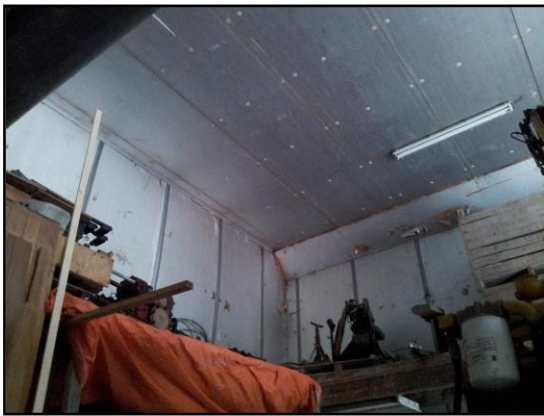
Foto 5: Hermetisch afgesloten koelcel
