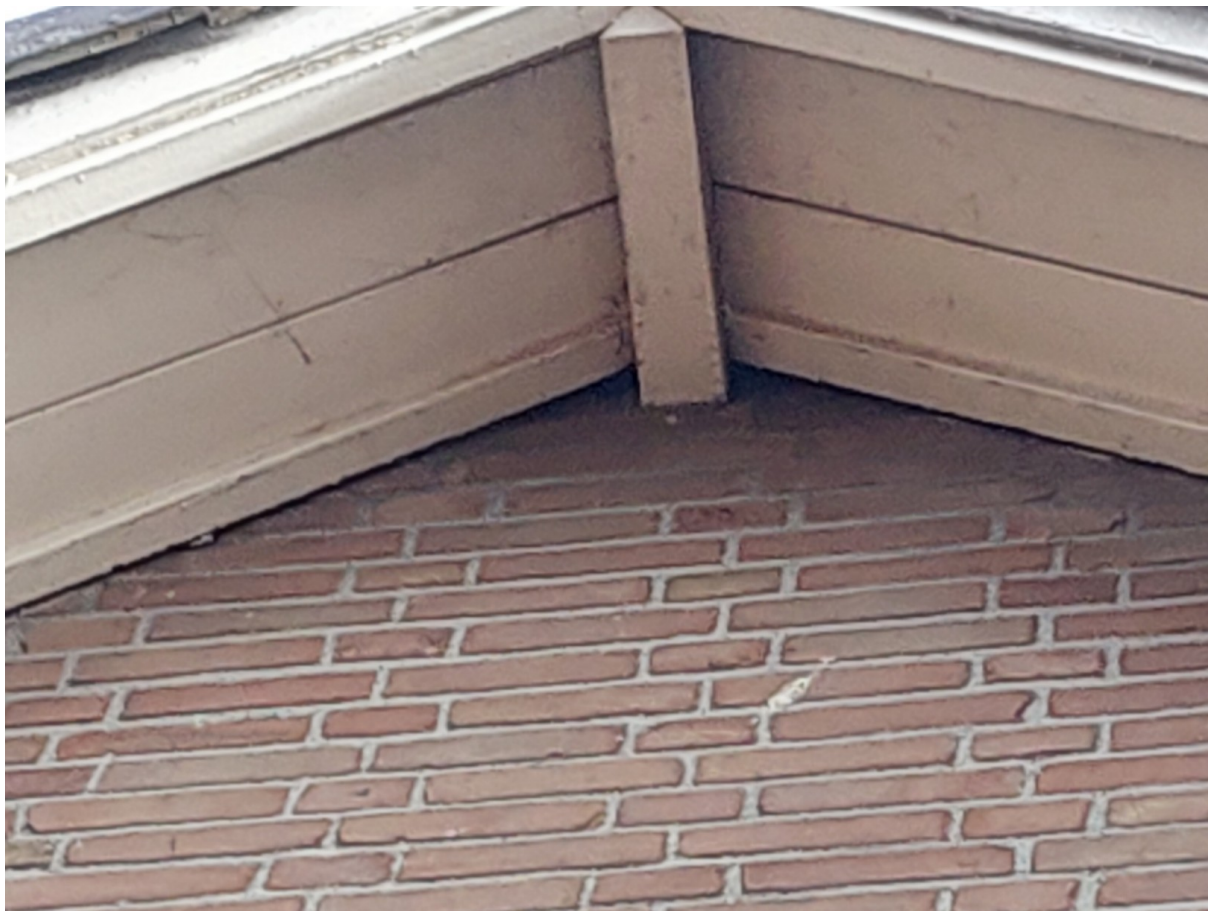
Op enkele plekken is onder het dakoverstek een kier aanwezig. Foto: K.C. Fokker | Ecoresult B.V.
