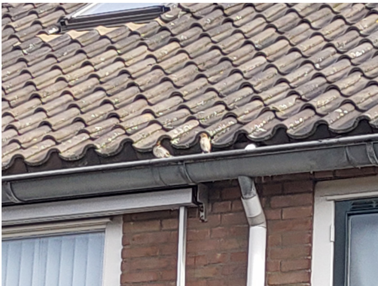
In de dakgoot van woningen aan de Marijkeweg werden huismussen waargenomen tijdens het veldbezoek, die onder de dakpannen kropen. Foto: K.C. Fokker | Ecoresult B.V.
