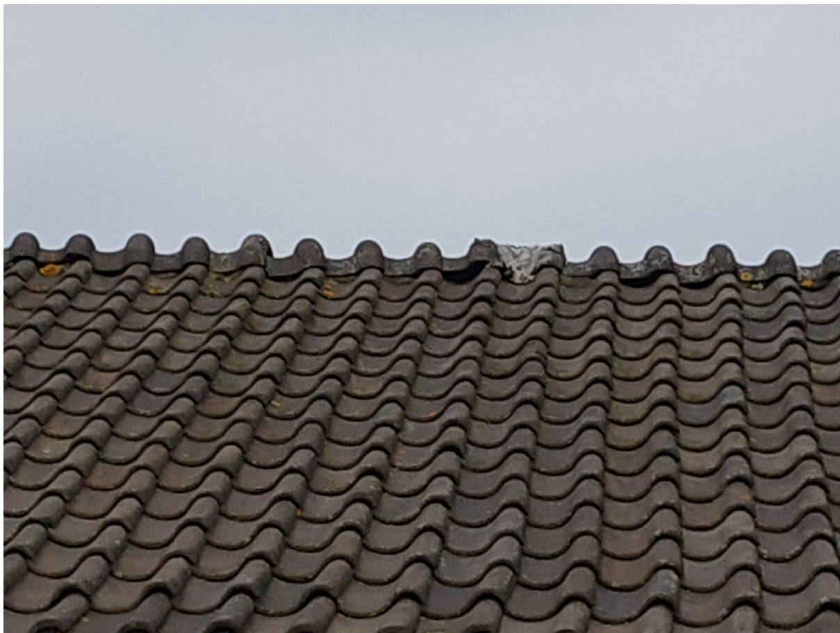
Op de daken liggen dakpannen, waarvan sommige wijken of ontbreken. Foto: K.C. Fokker | Ecoresult B.V.
