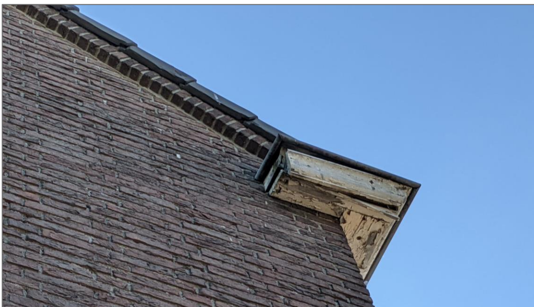
Ontbrekende/losliggende delen van de houten afwerking van de dakgoot van woning 350. Foto: E.M.C. Schonck | Ecoresult B.V.
