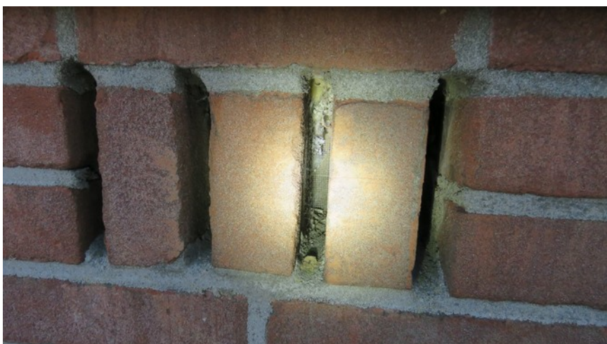
Afbeelding 9: De roostervormige stootvoegen van de kelder zijn aan de binnenzijde bekleed met fijnmazig gaas, hierdoor zijn inpandige (spouw) ruimten niet toegankelijk voor vleermuizen.
