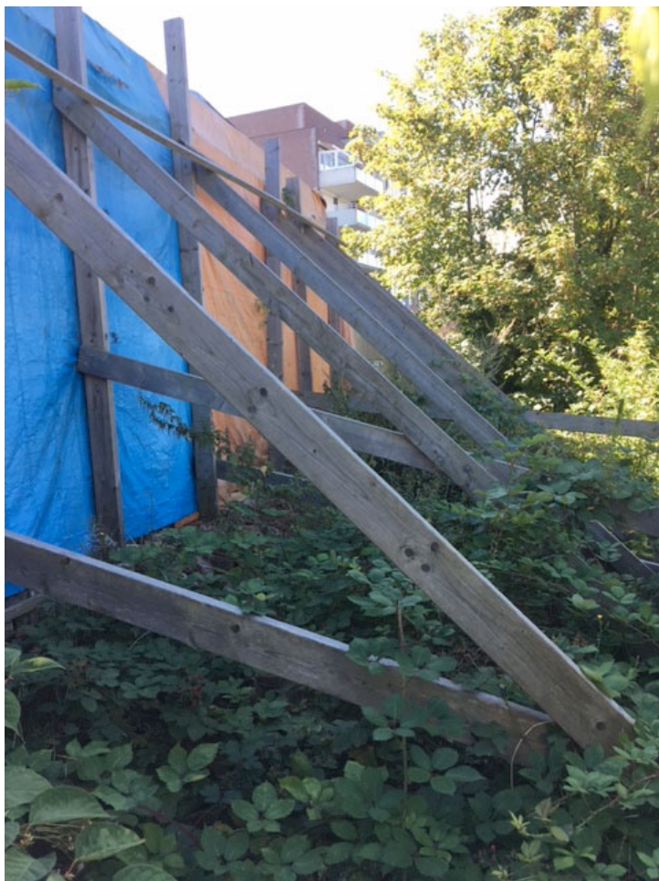
Foto Zicht op de zijmuur van Kerkbuurt 12. De muur wordt gestut en is voorzien van landbouwplastic. Het pand biedt noch aan deze zijde, nog aan de andere zijden, potenties voor gebouwbewonende vleermuizen. .
