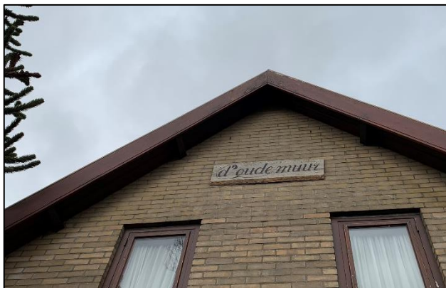
Foto 5: Open spouwgaten in woonhuis
