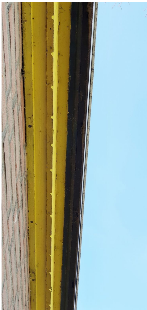
In en om de dakbekisting bevinden zich meerdere openingen en kieren. Foto: K. de Vries | Ecoresult B.V.
