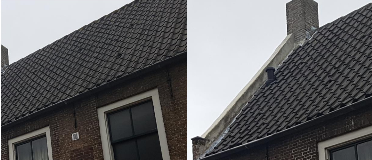
Figuur 6. Nestlocaties voor de gierzwaluw: (A) onder de onderste rij dakpannen, (B) op de overgang van loodslab en dakpannen.
