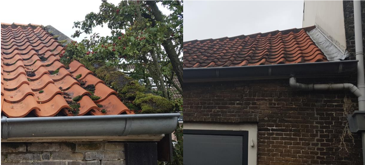
Figuur 5. Nestlocaties voor de huismus: (A) onder de onderste rij dakpannen, (B) onder de onderste rij dakpannen en onder de loodslab aan de rechterzijde.
