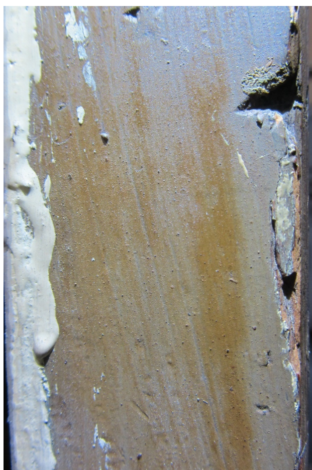
Afb. 18: De zgn. blauwgroene 'smeerlaag' aan de scharnierzijde van de deur.
