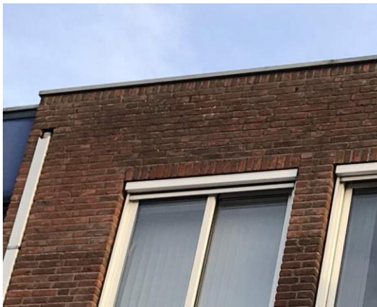
Afbeelding 10. Her en der open stootvoegen boven de ramen, onder de dakranden van het gebouw.
