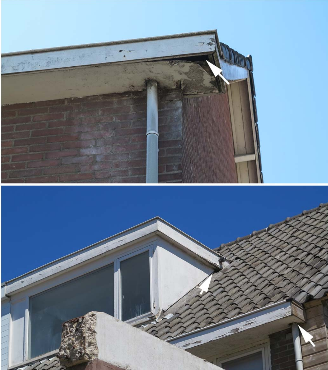
Figuur 3. In- en uitvliegmogelijkheden voor vleermuizen in het vervallen dakgedeelte van de drie woningen, met rottingsgaten in de daklijsten en toegang naar het dakbeschot en ruimten tussen houtpanelen of muurbetimmering.
